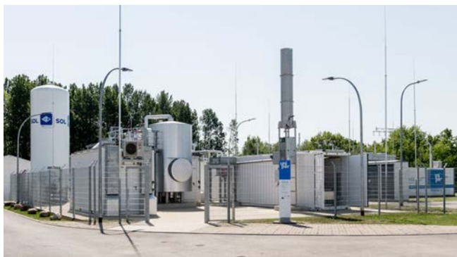
Fig. 5 - L'impianto dimostrativo Store&Go di Troia
